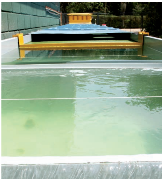
Estação de tratamento de água.
