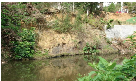
Figura 2: Saída de campo – Erosão nas margens do rio Naufrágio, em Presidente Nereu – SC Fonte: Jairo Formentin, 2006.
